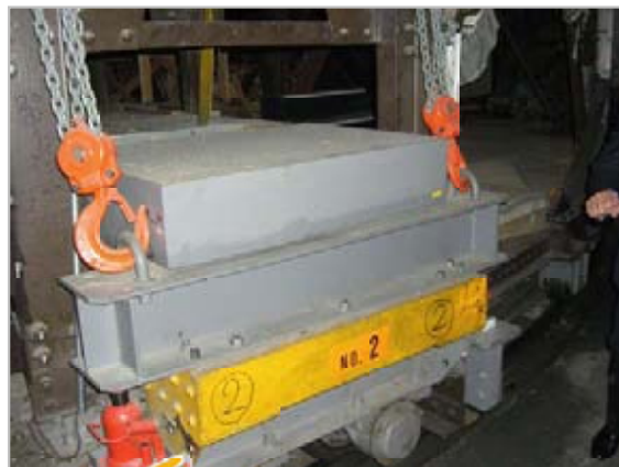
まわり舞台の機械が故障したとき、舞台を安定させるこの重しをつり上げ、手動で動かすそうです
