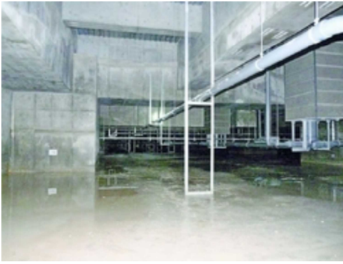
盛り土がなく地下水がたまっていた豊洲新市場の建物地下=7日、党都議団撮影
